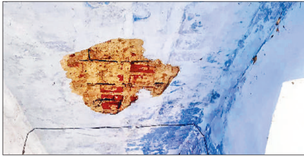
नारनौल। अकबरपुर स्कूल का जर्जर भवन। फोटो: हरिभूमि
